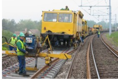
Longs Rails soudés sur traverses béton
